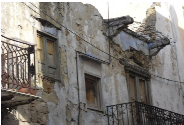
Case centro storico (rischio distacco tegole, pareti)
